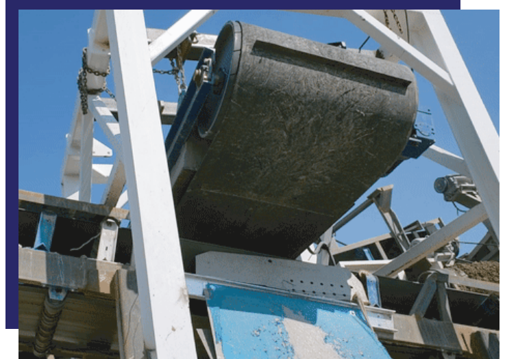
SEPARADOR ELECTROMAGNÉTICO DE AUTO-LIMPIEZA DESCARGANDO MATERIAL ATRAPADO EN UNA TOLVA
